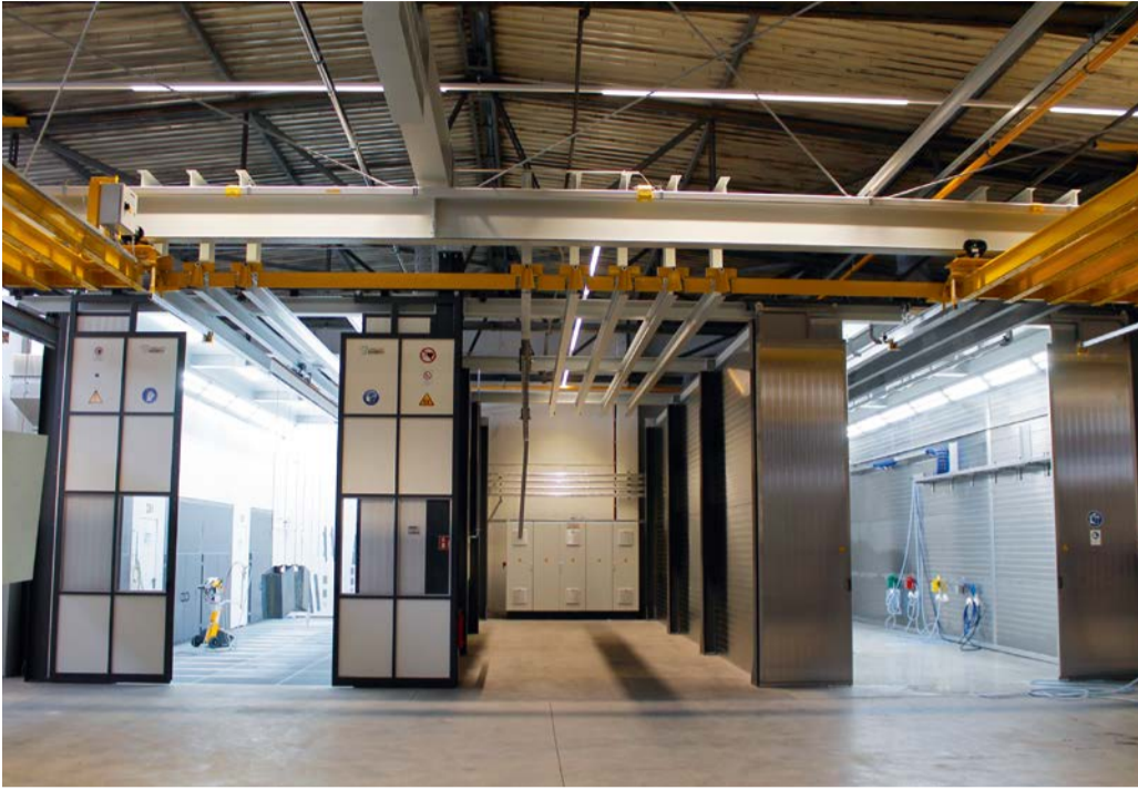
Die Anlage ist modular aufgebaut, hier der Blick auf die Pulver-, Abkühl- und Waschkabine.
